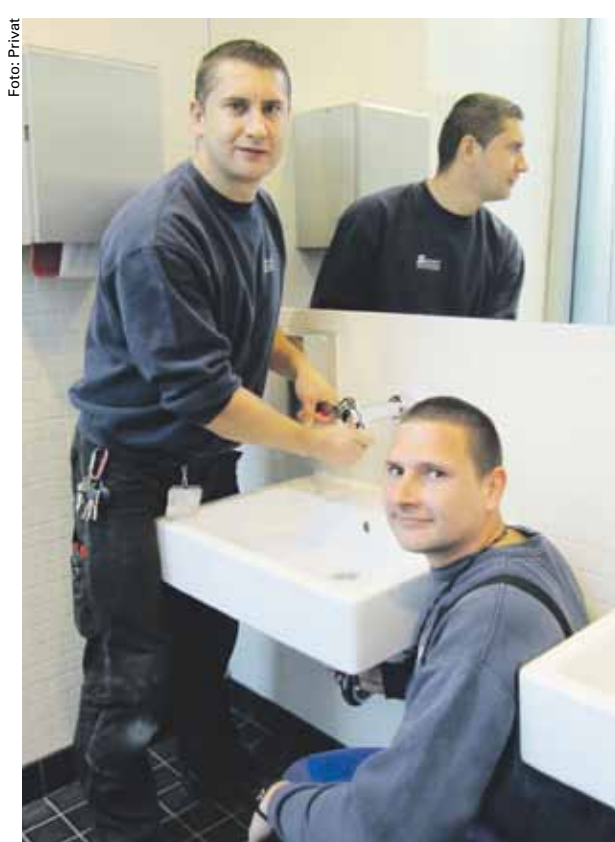
Weniger Wasserverbrauch: Elvir Sahinagic und Steven Boigk vom Technischen Gebäudemanagement beim Nachrüsten der Armaturen.
